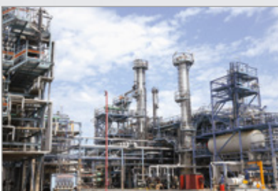
Equipamento de refinaria (opcional)
